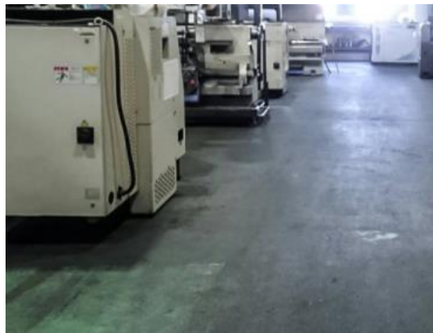
床の油汚れがひどくて 塗装できない
