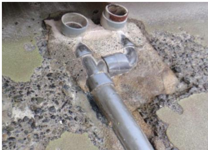
コンクリートが クラック・欠損している
